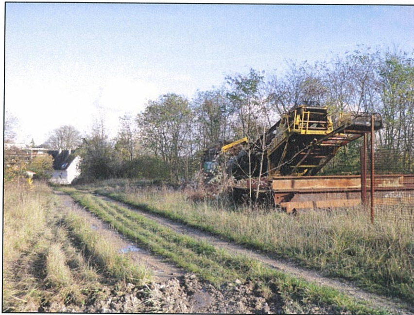
Figure 8 : Cliché du concasseur (Sources : SEMOFI, 2010)
