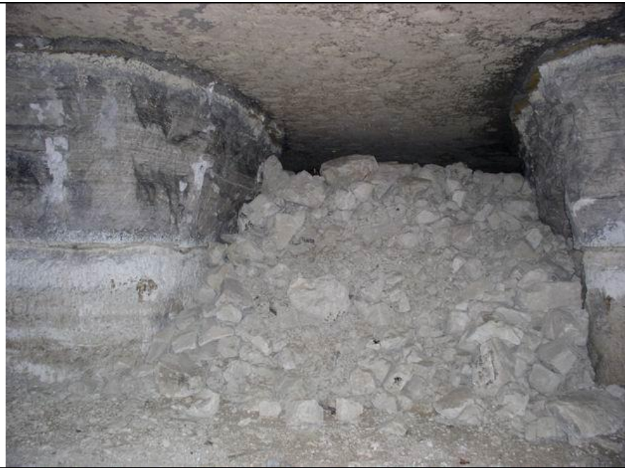
Comblement illégal et dangereux avec du gypse
